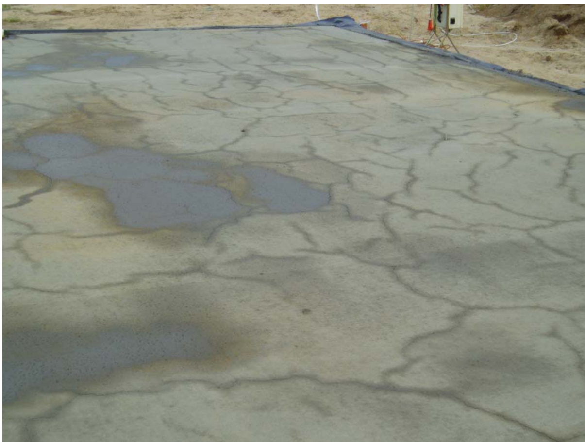
Figur 1: Plastiske svindrevner i nyudstøbt terrændæk.
