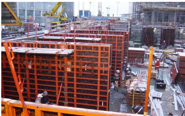
Klar til støbning af de tre første kældervægge med SCC, DR-Byen, Segment 3.
